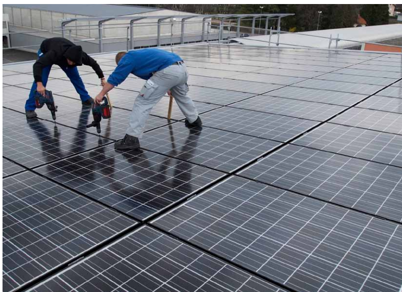
Grösste Fotovoltaikanlage des Kantons Freiburg, seit Frühjahr 2010, mit über 3000 Quadratmetern
